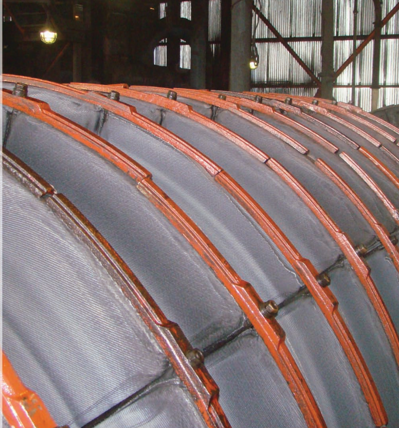
Filtros Planta de Pellets
